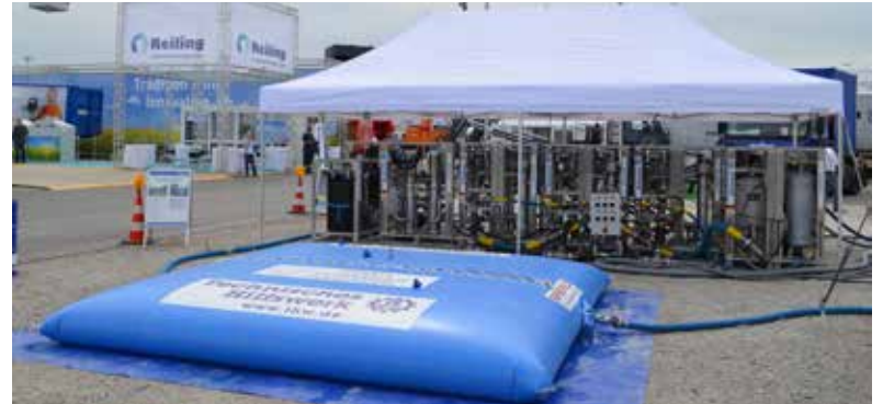
Trinkwasseraufbereitungsanlage (TWA) vom Typ Berkefeld UF 15.
