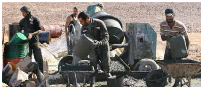
In al Azraq unterstützten die Bewohnerinnen und Bewohner vor allem Betonarbeiten. Foto: THW/Christiane Titze
